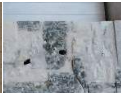
Trous dans les murs en moellons Source : Cittanova
