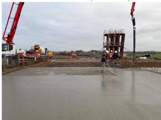
Aire de stockage (12/03/2020)
